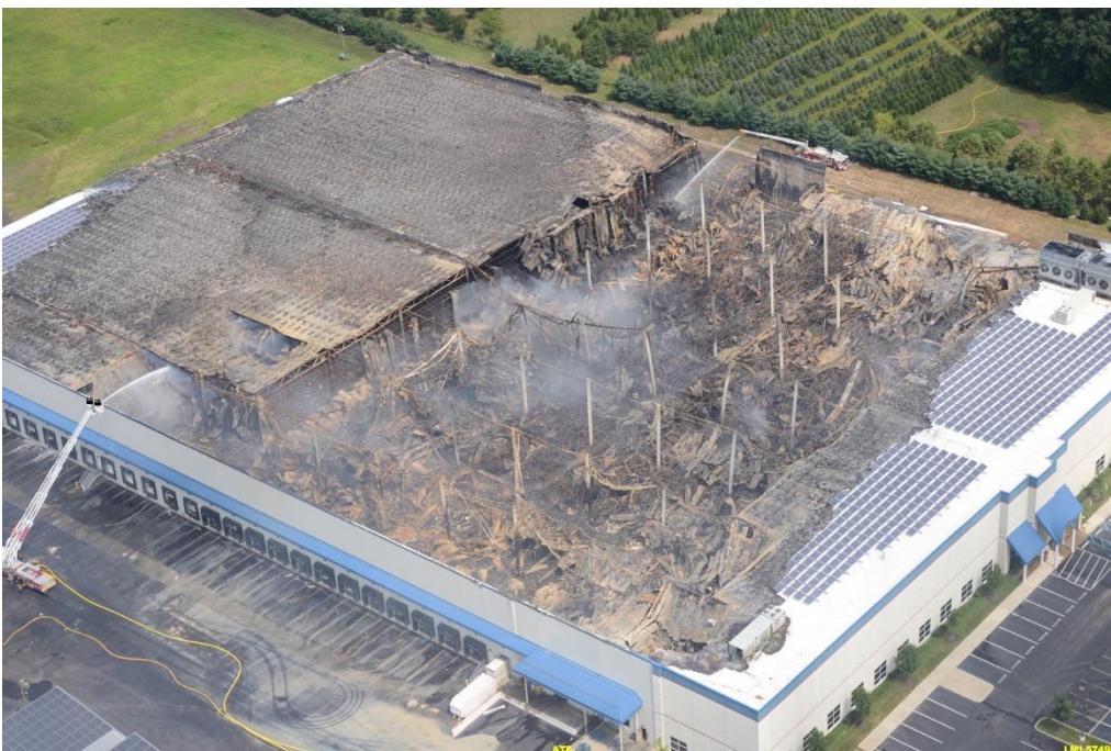
Aurinkosähköjärjestelmän tulipalo vuonna 2013 New Jerseyssä varastorakennuksessa, jonka katolla oli yli 8 000 aurinkopaneelia (Milke et al. 2014, 4-5). (Kuva: Reax Engineering)
